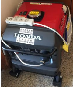
非常用発電機
